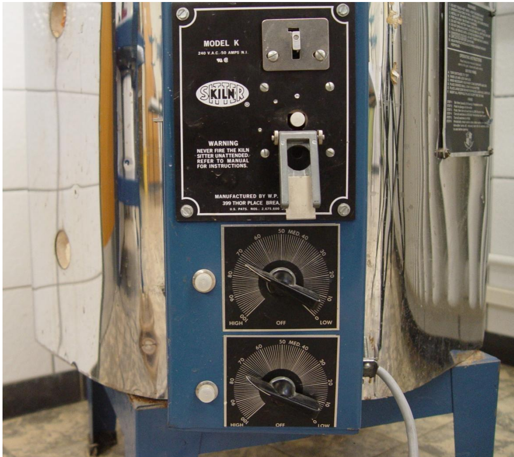
Bild 1: Ofen von außen, Foto
